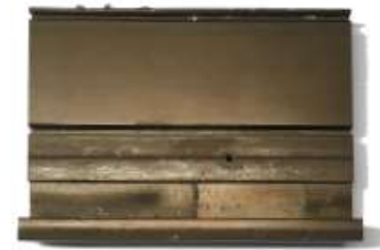
uitsnede bestaand stalen kozijn frontaal aanzicht is donkerder wegens verkleuring door weersinvloeden
