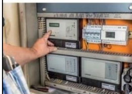
Beter inregelen van verwarming (kookthermostaat), ventilatie (CO 2 -sturing) en verlichting (daglichtregeling en bewegings-sensoren) bespaart 30 tot 40 procent energie.
