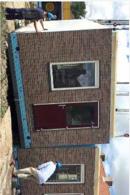
FOTO'S BOVEN EN ONDER: VERVANGENDE NIEUWBOUW IN PRAKTIJK: SLOOP VAN OUDE WONINGEN, ASSEMBLAGE EN NIEUWE WONINGEN GEREED.
