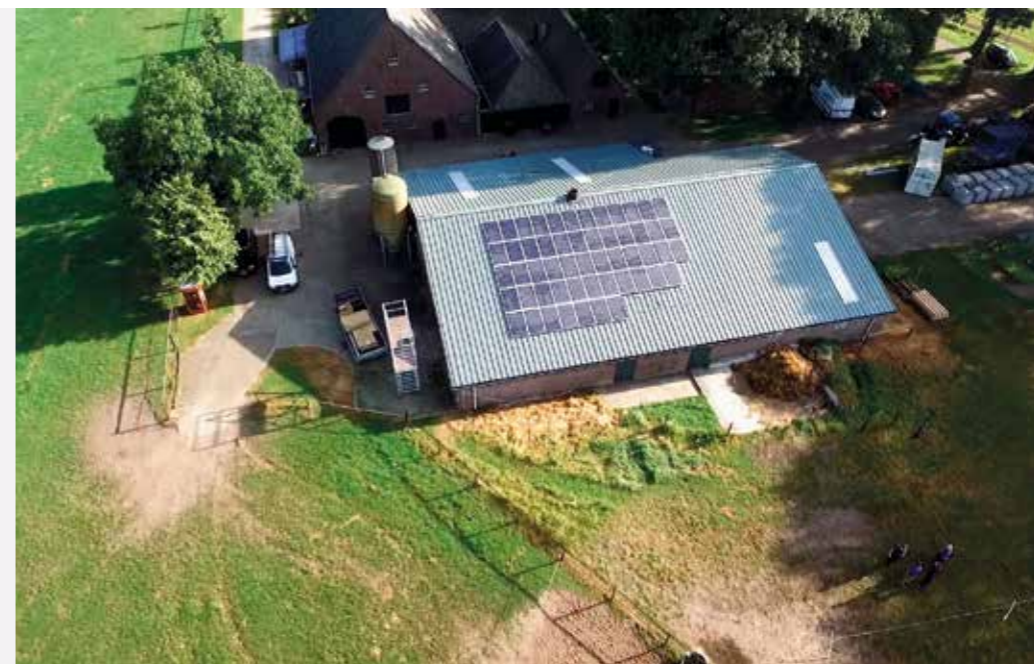
KINGSPAN FUTURE PROOF , EEN ENERGIEBESPARENDE TOTAALOPLOSSING VOOR VERVANGING VAN ASBESTDAKEN INCLUSIEF FINANCIERING. HET TOTAALPLAN BESTAAT UIT ASBESTSANERING TOT EN MET MONTAGE VAN EEN NIEUW DAKSYSTEEM MET ZONNEPANELEN EN LEDVERLICHTING.
